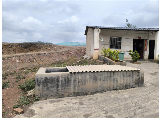
生活污水沉淀池
