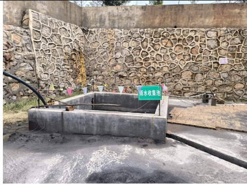
东南侧初期雨水收集池
