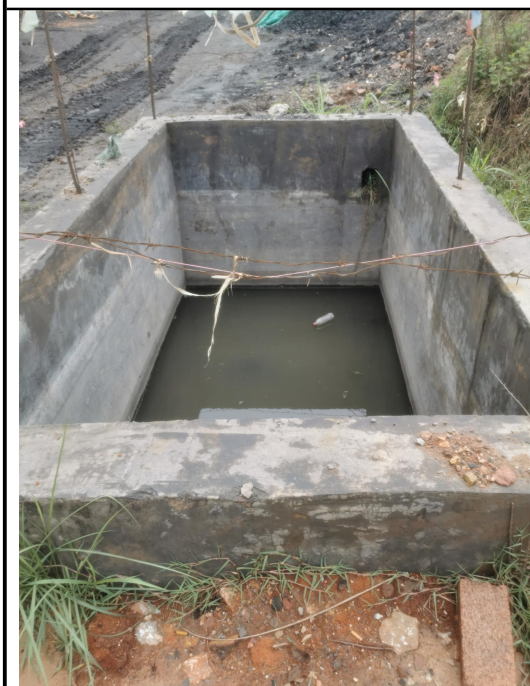
北侧初期雨水收集池
