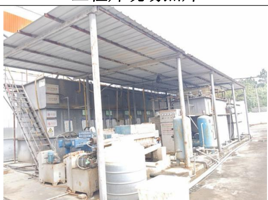
现有项目污水处理站
