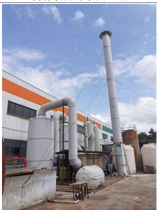
现有项目恶臭废气处理设施
